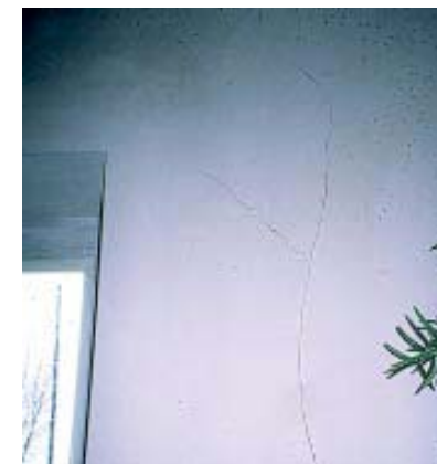
Moisissures, fissures... sont les tristes témoins d'un enduit extérieur au ciment dégradé.
